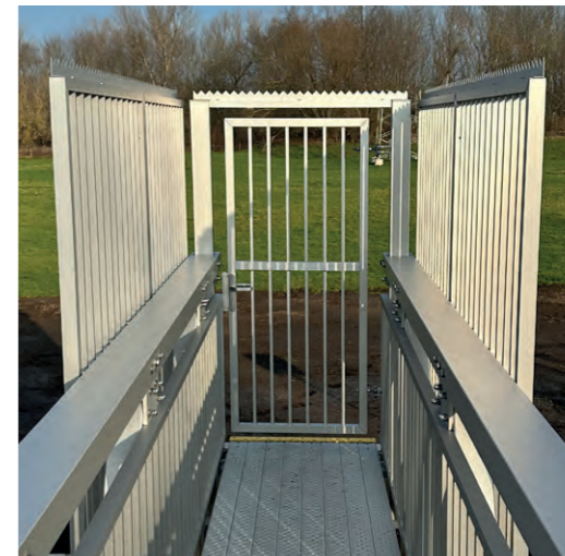
Stabgitterzaun auf beiden Seiten und abschließbare Tür
