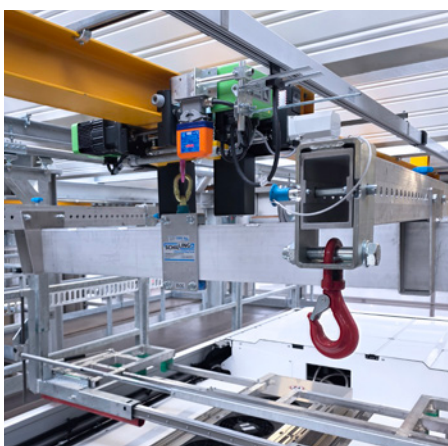
Elektrisch verfahrbarer Kran mit Traverse
