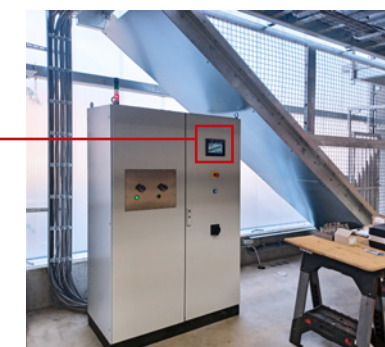
Schaltschrank mit Touchscreen zur modernen Steuerung der Dacharbeitsbühne
