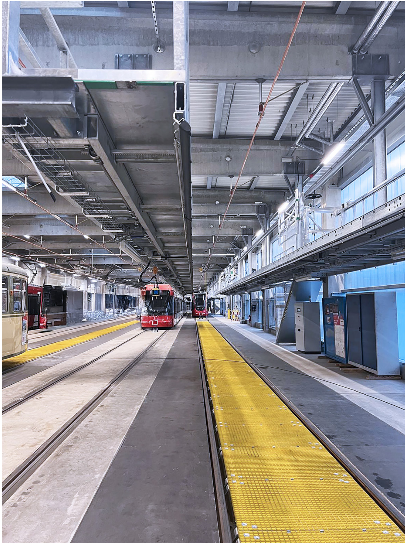
Gesamtansicht eines Teils des Dacharbeitsstands mit Schaltschrank für die Steuerung
